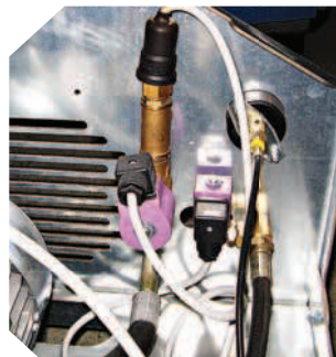
Электроклапан на входе воды, эл. клапа на линии высокого давления, манометр, датчик холостого хода/
